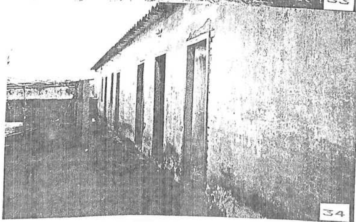
Foto - 33 - Magueirão com cercado de campo onde ficava retida a tropa durante a noite. Foto - 34 - Estalagem onde descansavam os tropeiros. Propriedade de Carlito Chaunn. Hidráulica. Quinto Distrito de Pelotas.
